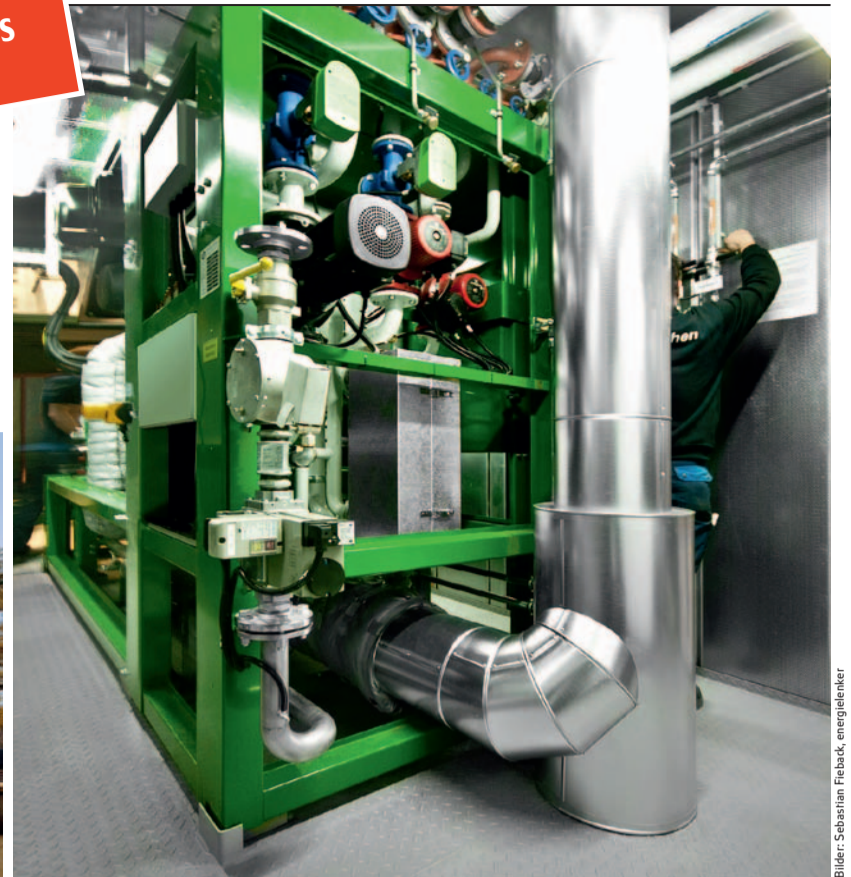
BHKW mit Bioerdgas: zehnjährige Planungssicherheit bei den Energiekosten
